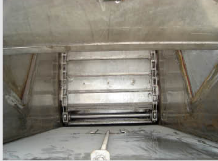
Oksit Çöktürme Havuzu / Oxide Sedimentation Pool
