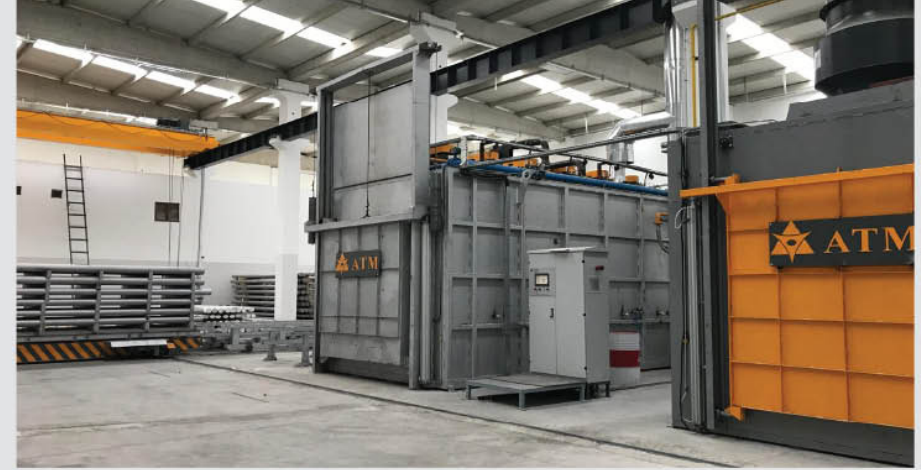
Homojenizasyon Tesisi / Homogenization Plant
